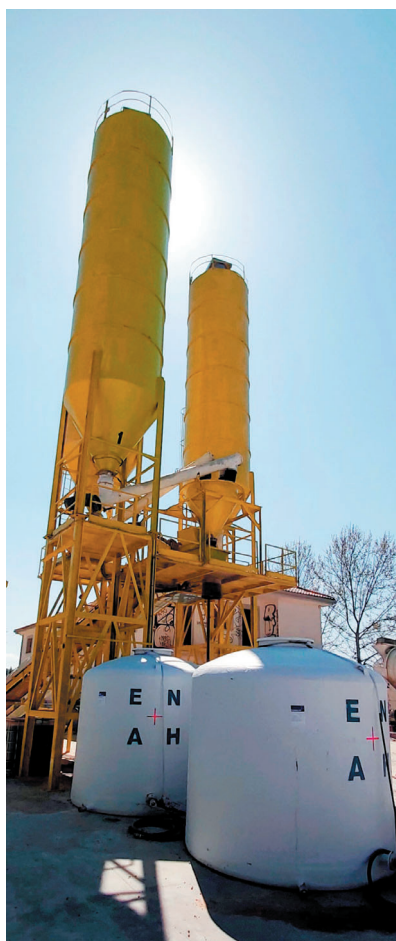
Planta de hormigón.
